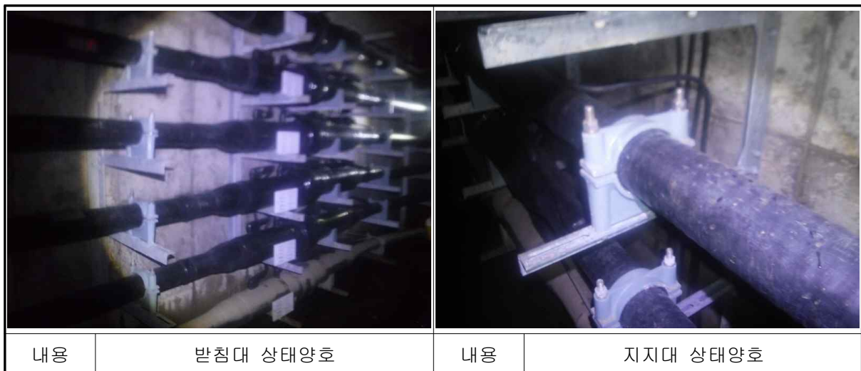
【사진 2.12】 부속 및 부대설비 현황
