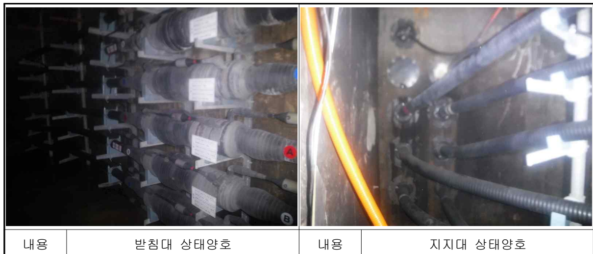
【사진 2.8】 부속 및 부대설비 현황
