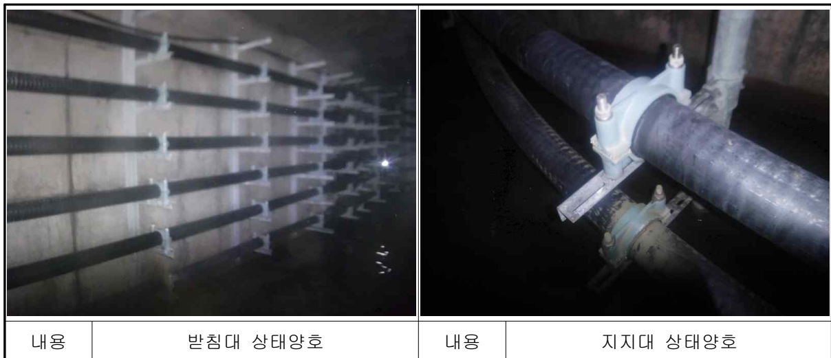
【사진 2.16】 부속 및 부대설비 현황
